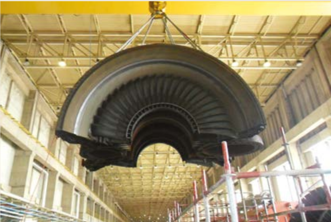
Cette année a été marquée par la réalisation de la révision de l'Unité 4 conformément au Plan de Maintenance opérationnel.
